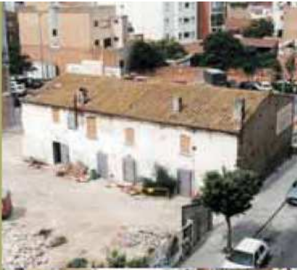
Vista de les Cases d'en Puig el setembre de 1998, abans de la seva rehabilitació.
